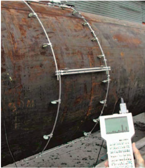
Figura 1. Detección de zonas de concentración de esfuerzos y grietas en una tubería de vapor usando el método de memoria magnética. 1
